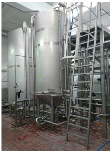
Общий вид колонны-ополаскивателя с буферной емкостью воды
