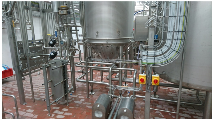
Колонна-ополаскиватель с системой охлаждения и насосами для циркуляции воды
